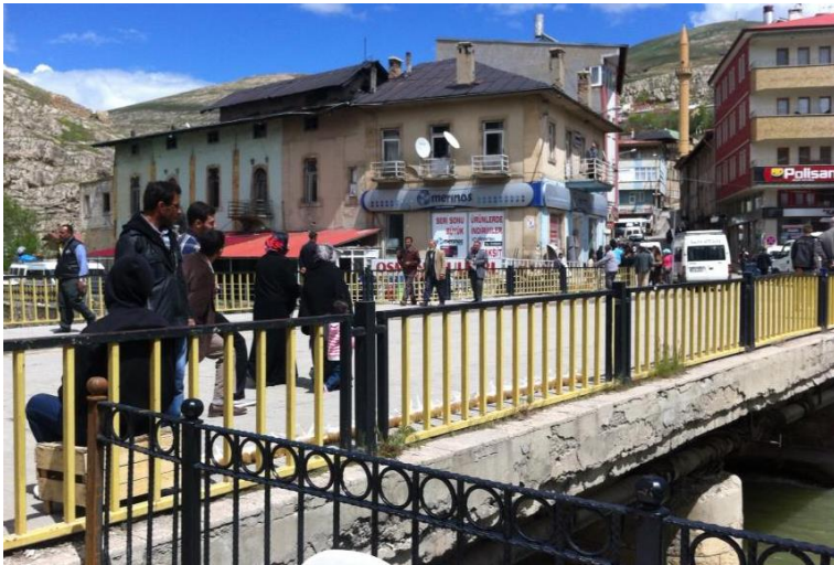
Aynı yapının bugünkü içler acısı halini!
